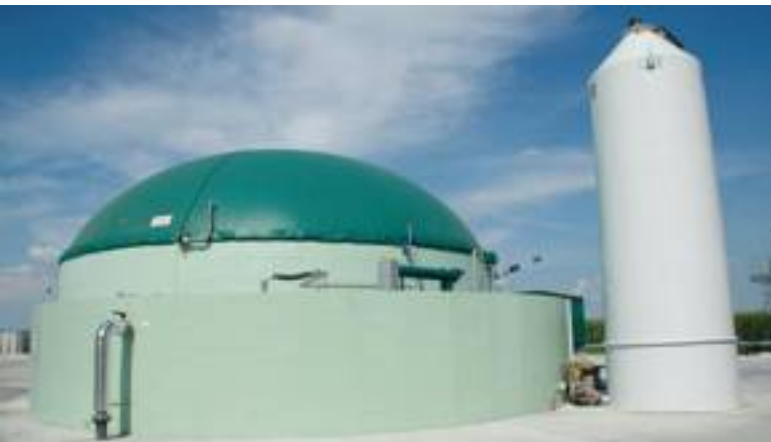
● Il biodigestore dell'azienda Romani funziona principalmente con reflui. Grazie ad alcuni accorgimenti, i proprietari riescono a mantenerlo efficiente e vicino alla potenzialità massima.
