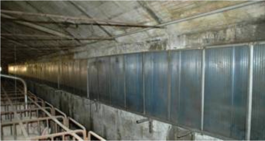
Un sistema di grate mobili permette di chiudere l'ingresso dell'aria nei mesi freddi. A differenza del primo impianto. Il controllo è affidato a una centralina elettronica.
